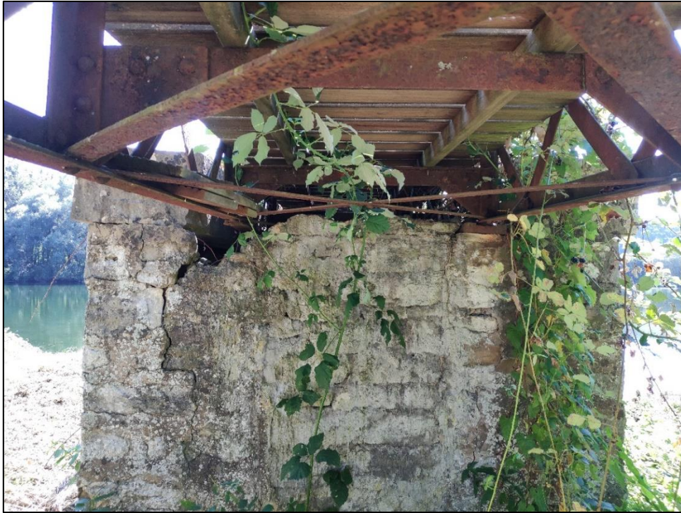
Figure 6 : Vue d'un appui sur berge fortement dégradé
